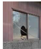
窓が割れた 管理不全空家
