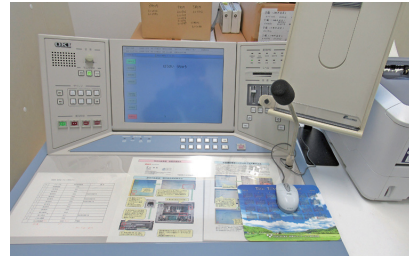
防災無線放送設備
